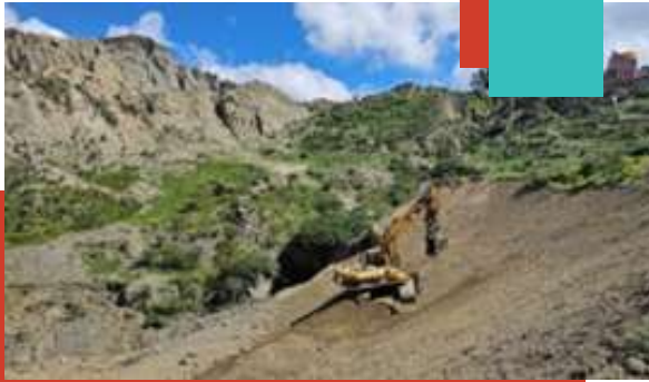
Fotografía. Río. Kupini I y III (Zona Kupini Central). Intervención con maquinaria, conformación de banquetas para la estabilidad del talud por la pérdida de barreras transversales de gaviones, poniendo en vulnerabilidad a viviendas y tránsito vehicular y peatonal a la zona de Obrajes, altura calle 17.
